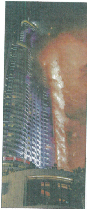
Silvesterbrand: In Dubai ging die Fassade dieses Hotels einige Stunden vor dem Feuerwerk in Flammen auf. Foto: dpa
